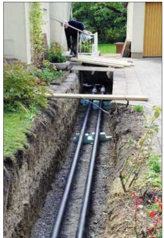
Bild 2. Hausanschlussleitung in Unterföhring
