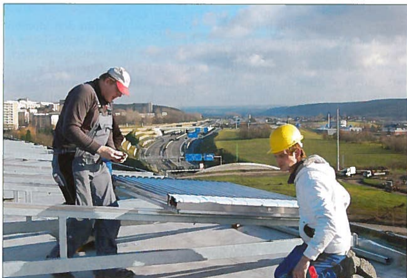
Bild 2. Als Contractor betreibt die RGM auch eine Solarthermieanlage
